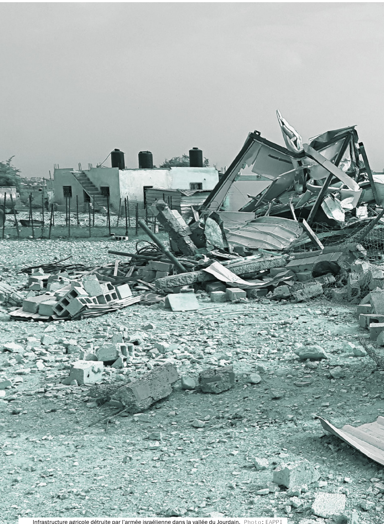
Infrastructure agricole détruite par l'armée israélienne dans la vallée du Jourdain. Photo: EAPPI
